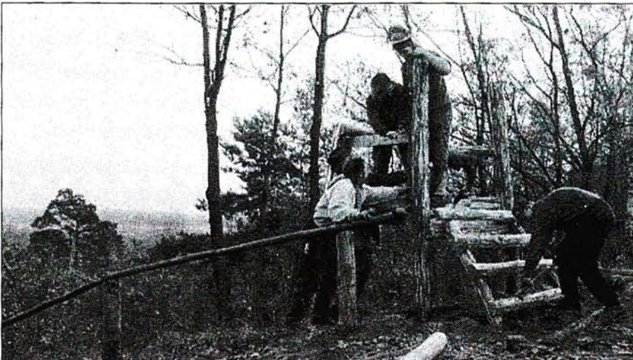
EINEN BLICK IN DIE WETTE kann man künftig von dieser Aussichtsplattform genießen, welche die Freiwilligen unter Anleitung von Oberförster Hubertus Krüger bauten. Foto: Andreas Klaer
